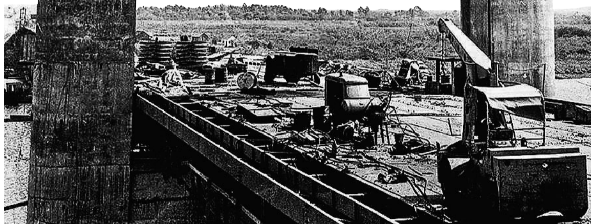
A obra da ponte do Guaíba. Abaixo, vista aérea da área, antes de existir a Avenida Castelo Branco
